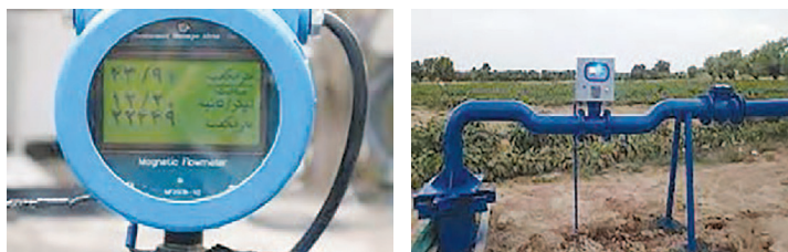
کنتورهای هوشمند، راهی برای اندازه‌گیری و کنترل برداشت از چاه‌ها
